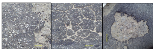
Figura 4: Painela, Trincas e Desgaste encontradas na via em estudo.
