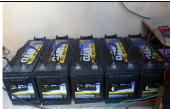
Figura 2: Banco de baterias do sistema eólico-elétrico
